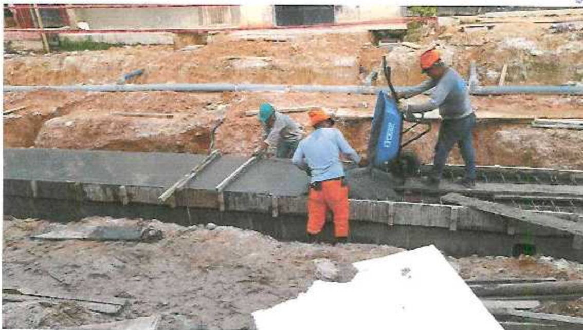
FOTOGRAFÍA 12: VACIADO DE MORTERO ARMADO EN TECHO DE ALCANTARILLA EN LA CALLE URARINAS
